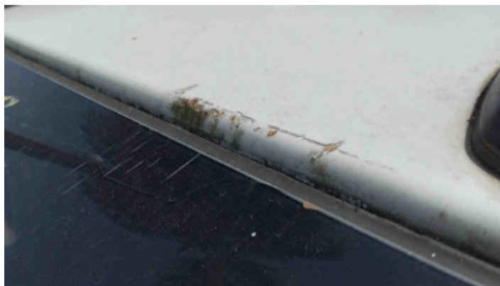
Foto Avaria Teto
