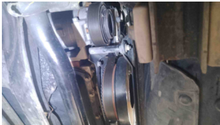
Foto Ar Condicionado
