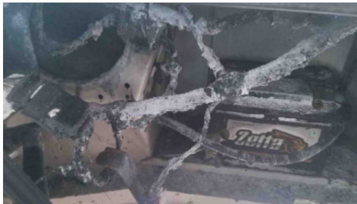
Detalhe da Avaria
