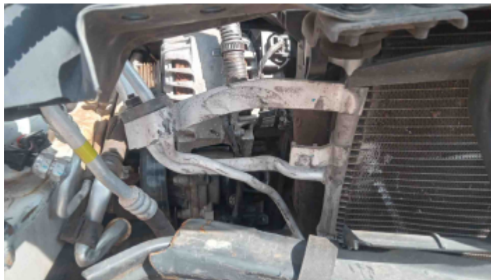
Foto Ar Condicionado
