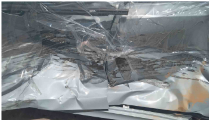
Detalhe da Avaria
