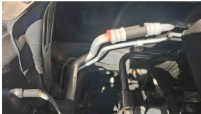
Foto Ar Condicionado
