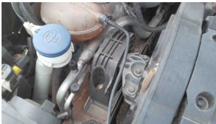
Foto Ar Condicionado
