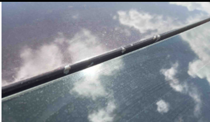
Foto Avaria Teto
