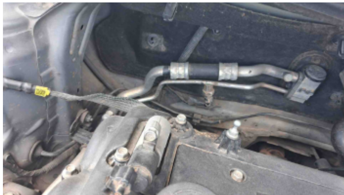
Foto Ar Condicionado
