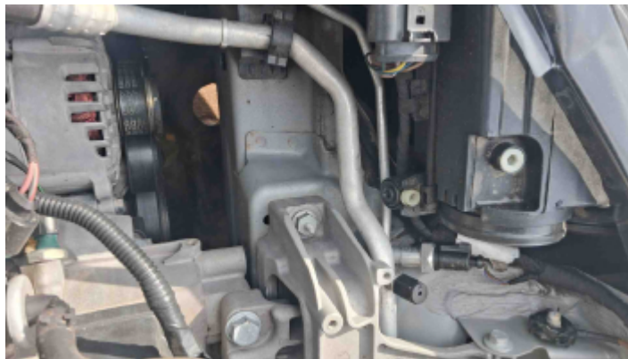
Foto Ar Condicionado
