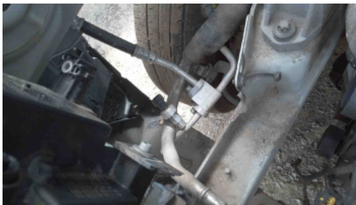
Foto Ar Condicionado
