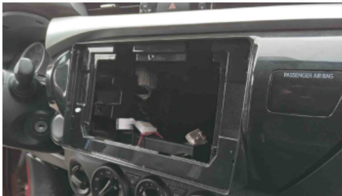
Detalhe da Avaria
