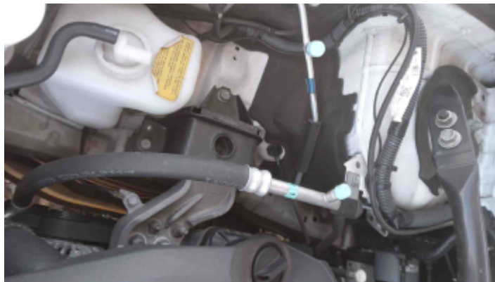
Foto Ar Condicionado
