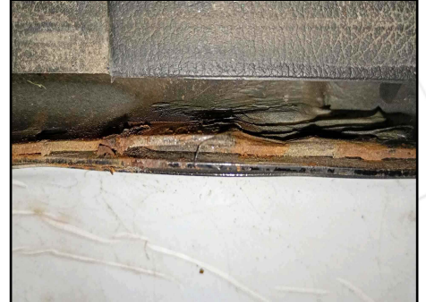
CAIXAS DE AR - SOLEIRA ESQUERDA
