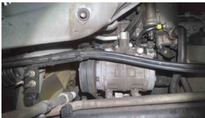
Foto Ar Condicionado
