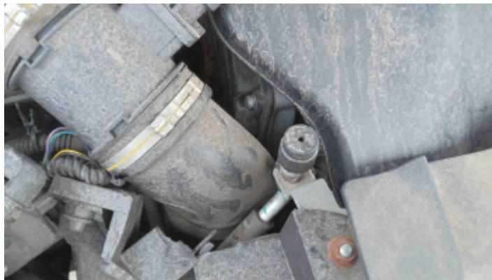
Foto Ar Condicionado
