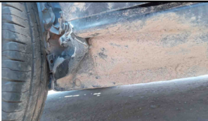
Detalhe da Avaria
