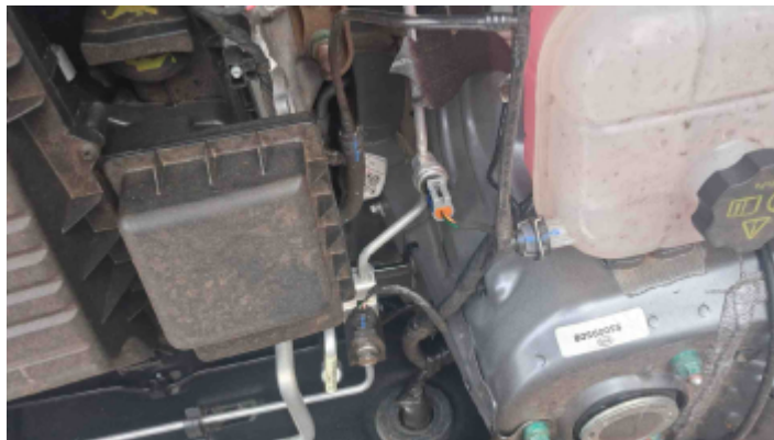
Foto Ar Condicionado
