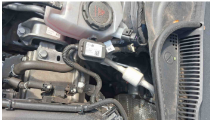
Foto Ar Condicionado
