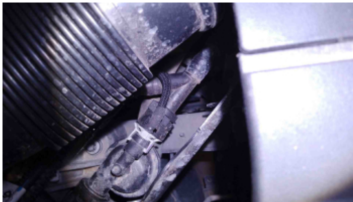
Foto Ar Condicionado
