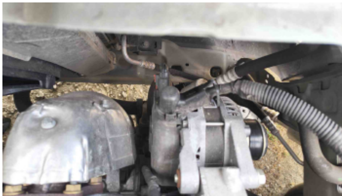
Foto Ar Condicionado
