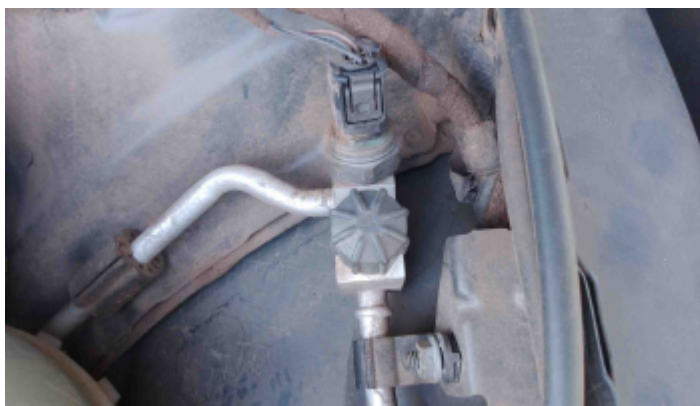
Foto Ar Condicionado
