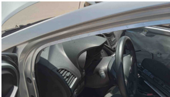
Foto Estrutura Coluna Dianteira Esquerda
