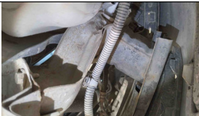
Foto Avaria Painel Dianteiro
