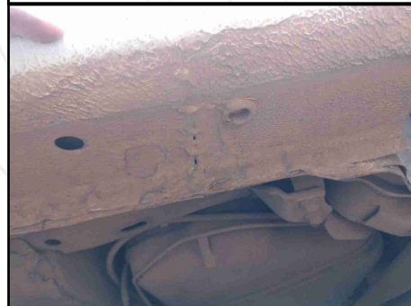
CAIXAS DE AR - SOLEIRA ESQUERDA
