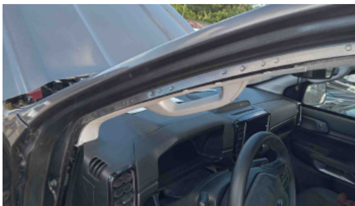
Foto Estrutura Coluna Dianteira Esquerda
