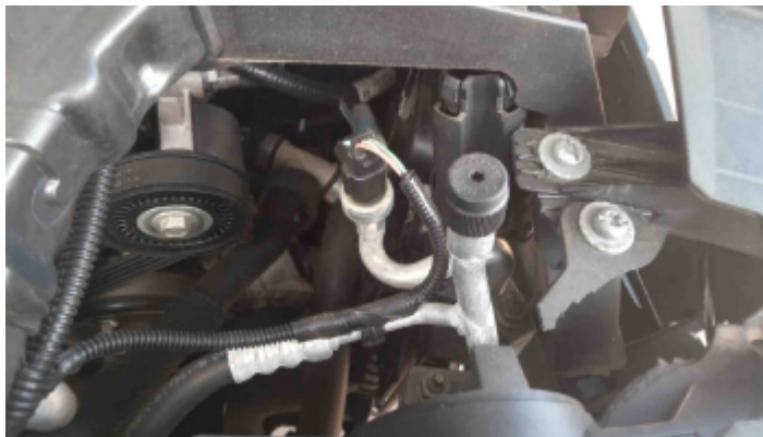
Foto Ar Condicionado
