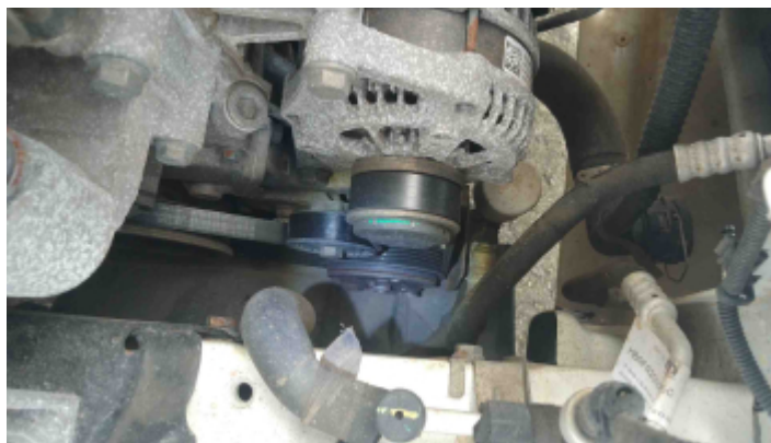
Foto Ar Condicionado
