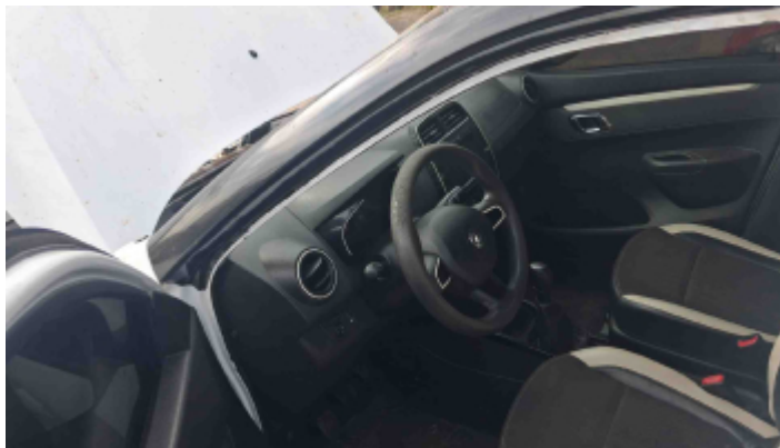
Foto Estrutura Coluna Dianteira Esquerda
